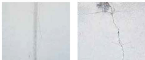
外壁表面のみのひび割れ 外壁内部からのひび割れ
