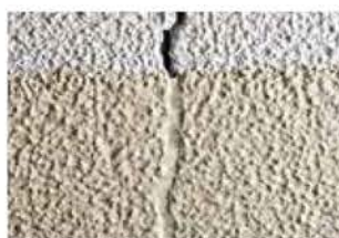
ひび割れに追随
