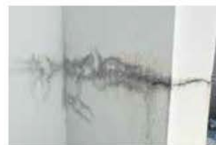
剥落につながるコンクリートのひび割れ
