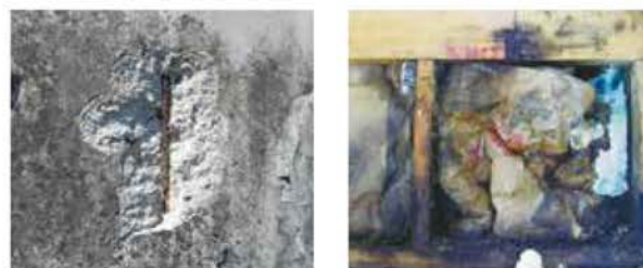
外壁材の剥落 建物内部の腐食
