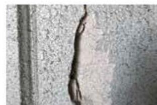
雨漏りにつながるALCのひび割れ
