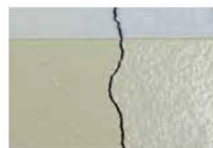
ひび割れが表面化
