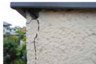
雨漏りにつながるモルタルのひび割れ
